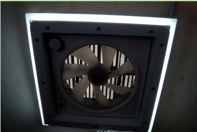
Deckenlüfter mit zuschaltbarer Innenbeleuchtung
